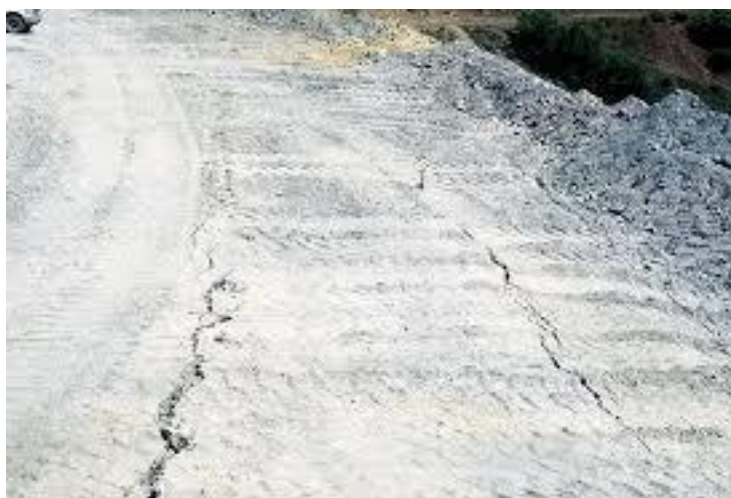
Рисунок 2.49. Недоуплотнение отвалов может привести к их обрушению
